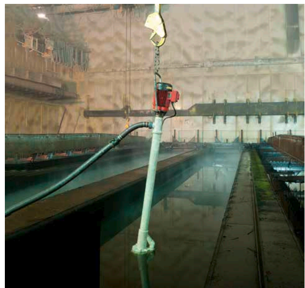
F 640 - Bombeo de sulfúrico diluido de un tanque de decapado.
